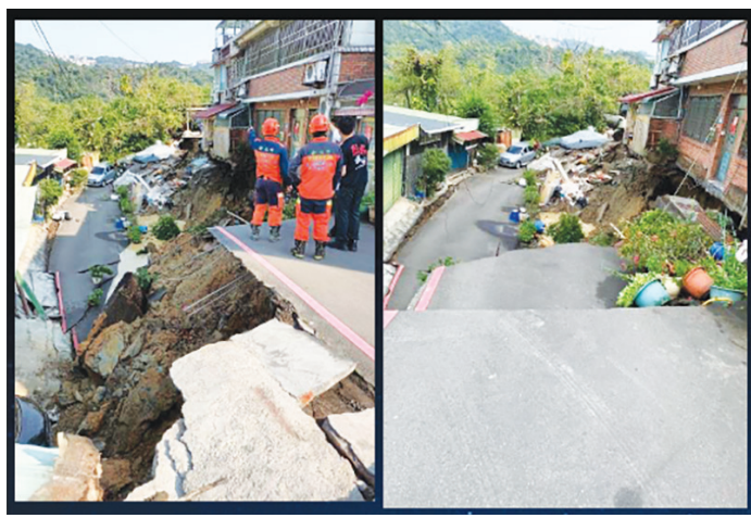
▲新店區安泰路地基掏空，土陷嚴重。
