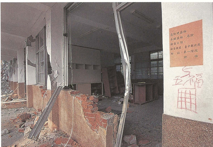
一場大震後，許多教室都成了危險建物。
